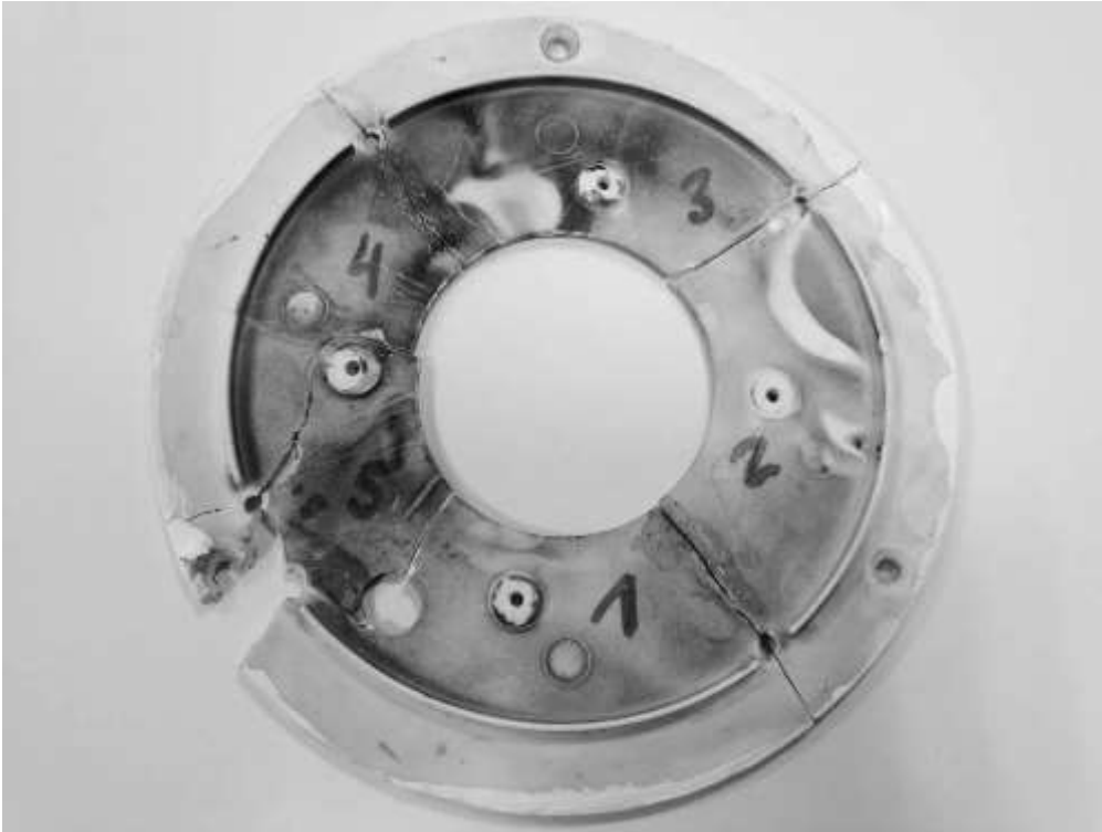
Abb. 2 gebrochene Verbindungsplatte Trafoglocke - Zimmerdecke
